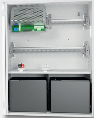
Enhet med 40Ah batterier
